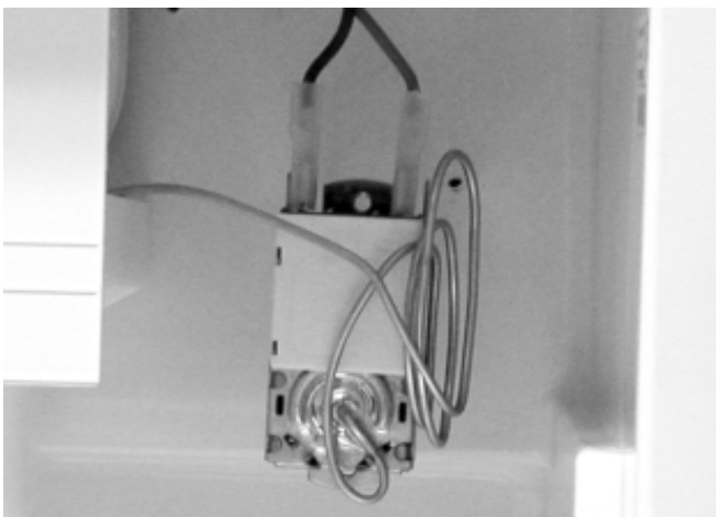
Figura 4.0 - Interior del Termostato
